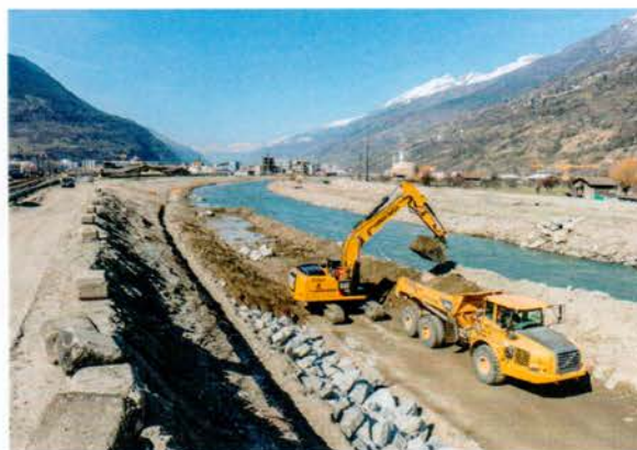
Hochwasserschutzbauten sollten besonders nachhaltig sein: Arbeiten an der 3. Rhonekorrektur, einem der Pilotprojekte des SNBS Infrastruktur
