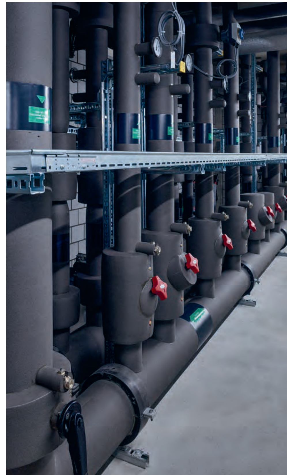
L'un des principaux distributeurs de froid pour les trois bâtiments du centre commun d'énergie frigorifique.
