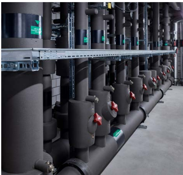
Un des principaux répartiteurs de froid pour les trois bâtiments dans la centrale de refroidissement commune.
